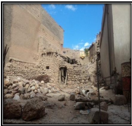
Photo N° 07 : Effondrement de la vieille ville de Menàa (Batna)
