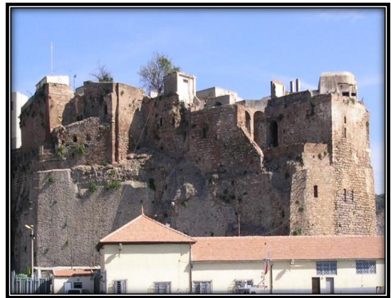
Photo N° 12 : La Casbah de Bejaia menace ruine (Juin 2012)
