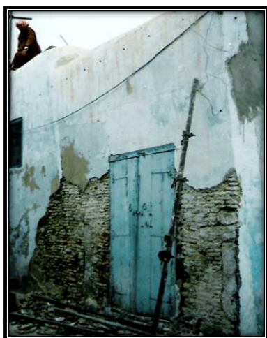
Photo N° 01 : Dégradation du cadre bâti dans le tissu urbain traditionnel de Kairouan
