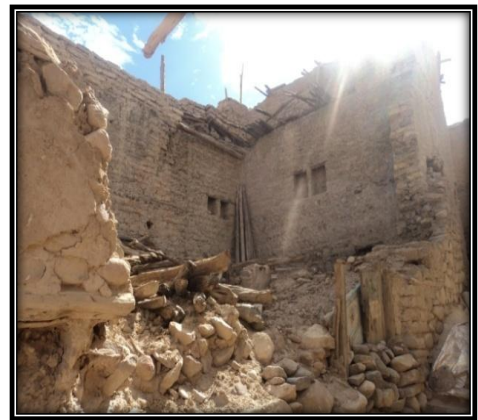
Photo N° 08 : Effondrement de la vieille ville de Menàa (Batna)
