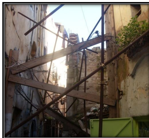
Photo N° 18 : Effondrement de la même bâtisse (Décembre 2012)
