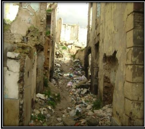
Photo N° 09 : Effondrement des parties de la vieille ville de Constantine
