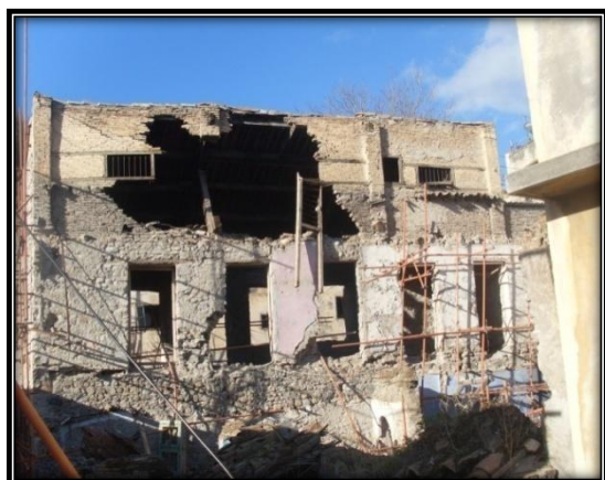
Photo N° 15 : Effondrement de plusieurs maisons dans la basse Souika
