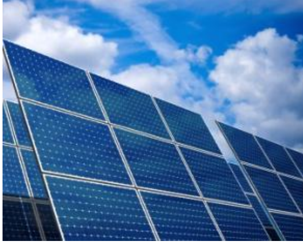
إنتاج الكهرباء من الطاقة الشمسية: الألواح الكهروضوئية PV
